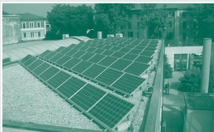
Esempio di pannelli fotovoltaici su tetto a terrazzo
